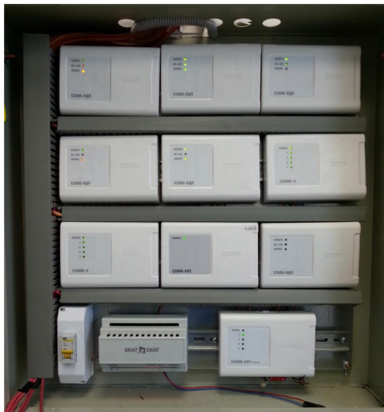
Рисунок 12. Фотография монтажного шкафа
